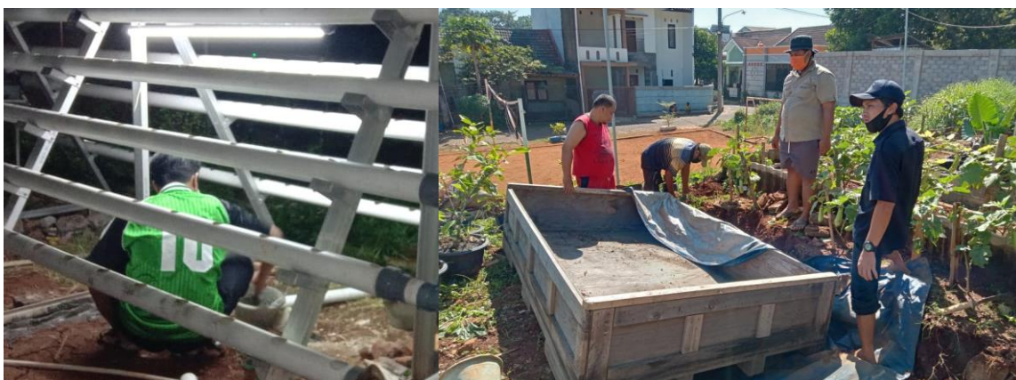
Gambar 1. Proses pembuatan instalasi aquaponik
