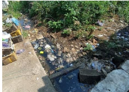
Gambar 4. Kondisi Salah Satu Ruas Saluran Drainase Di Desa Klidang Lor.
