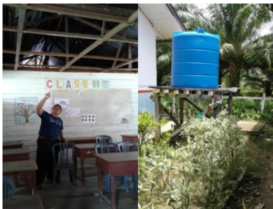
Gambar 2. Ruang kelas dengan plafon yang sudah lepas dan bak penampung air hujan untuk MCK (Dokumentasi Pribadi, 2018).
