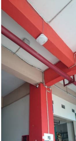
Gambar 10. Saluran pipa hidran Sumber: Hasil Observasi, 2018
