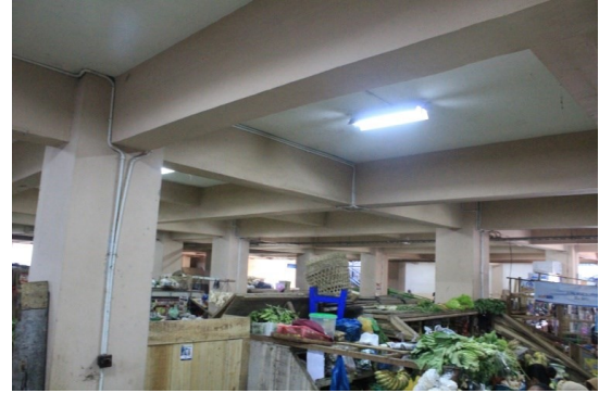
Gambar 11. Lantai basement tanpa lampu darurat
