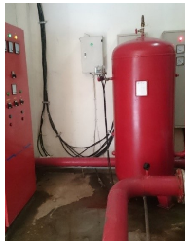
Gambar 9. Panel yang ada di ruang hidran Sumber: Hasil Observasi, 2018
