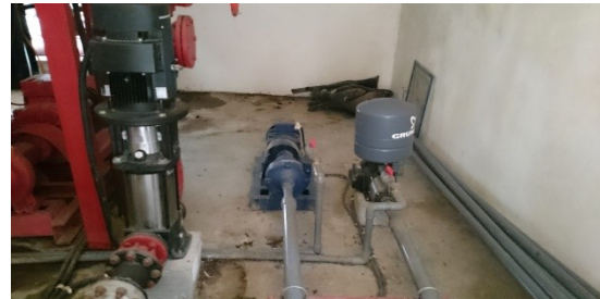
Gambar 8. Pompa yang ada di ruang hidran Sumber: Hasil Observasi, 2018
