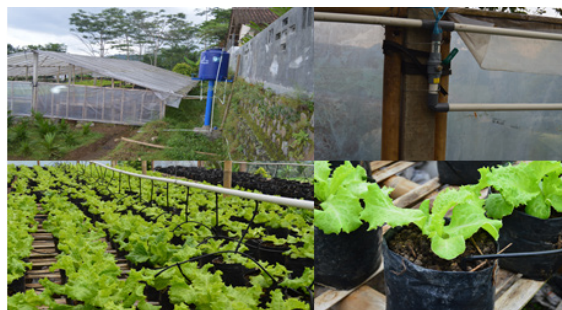
Gambar 2. Instalasi irigasi tetes
