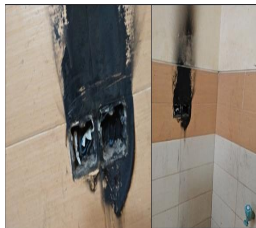
Gambar 4. Terbakarnya saklar di ruang toilet putra lantai 1 Gd C. (Sumber penelitian)
