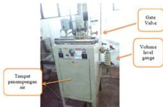
Gambar 1 Boiler Penghasil Uap
