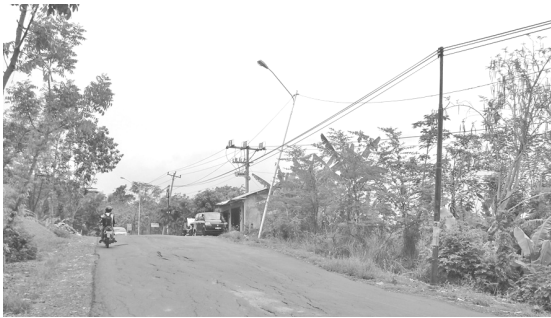
Gambar 14. Kondisi gerakan massa tanah di Trangkil
