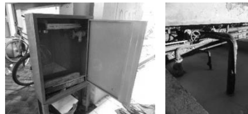
Gambar 30. Infrastruktur Fire Protection
