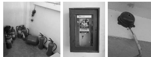
Gambar 21. Infrastruktur Fire Protection
