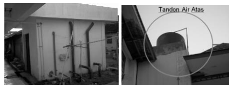
Gambar 6. Jaringan Air Bersih di Rusunawa Juminahan
