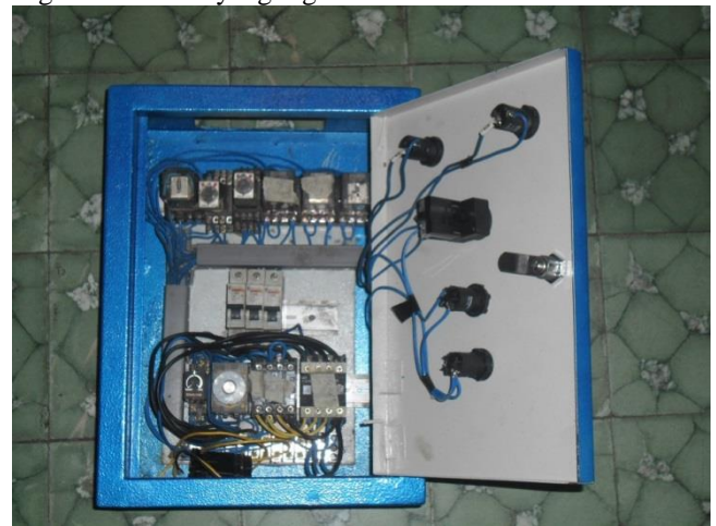
Gambar 12. Pengkabelan Rangkaian ATS.
