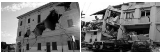
Gambar 1. Kerusakan pada dinding bangunan akibat gempa
