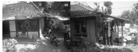
Gambar 1. Rumah Kayu dan Rumah Tembokan Yang Mengalami Kemiringan
