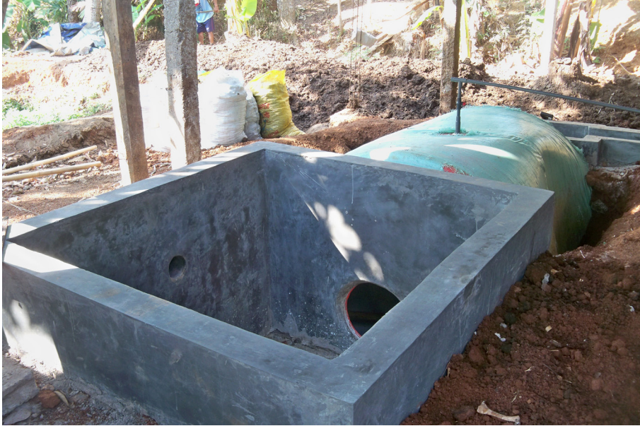
Gambar 5. Instalasi reaktor biogas siap dioperasikan
