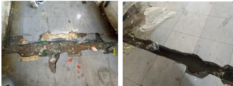
Gambar 2. Saluran Drainase di Pasar Flamboyan
