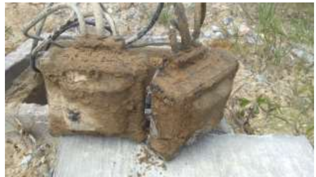
Gambar 4. Trafo Series pada PAPI
