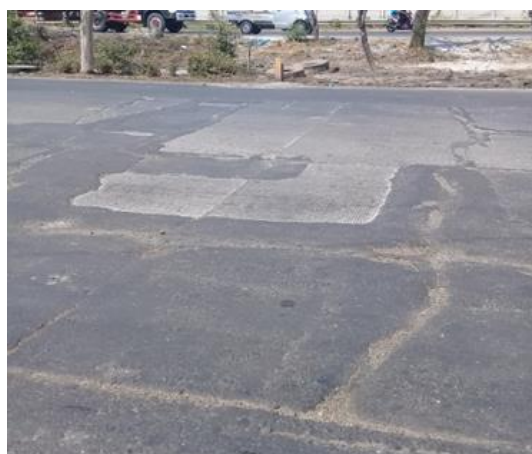
Gambar 8. Jalan Yos Sudarso yang Rusak
