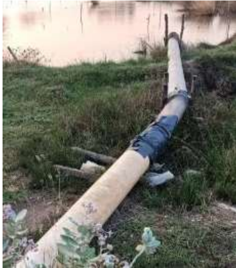
Gambar 6. Saluran pipa menuju ke tambak
