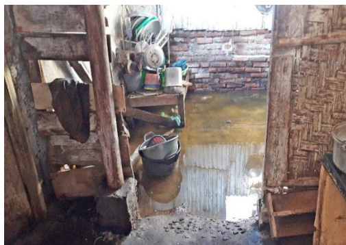
Gambar 8. Kondisi Dapur dengan Lantai Tanah (Sumber: Dokumentasi Penulis, 2017)
